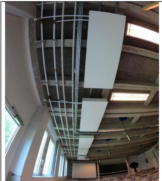
Systeem voor 'free cooling' en 'natural cooling'
