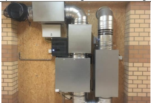
Ventilatie C met dampers en CO 2 -sturing
