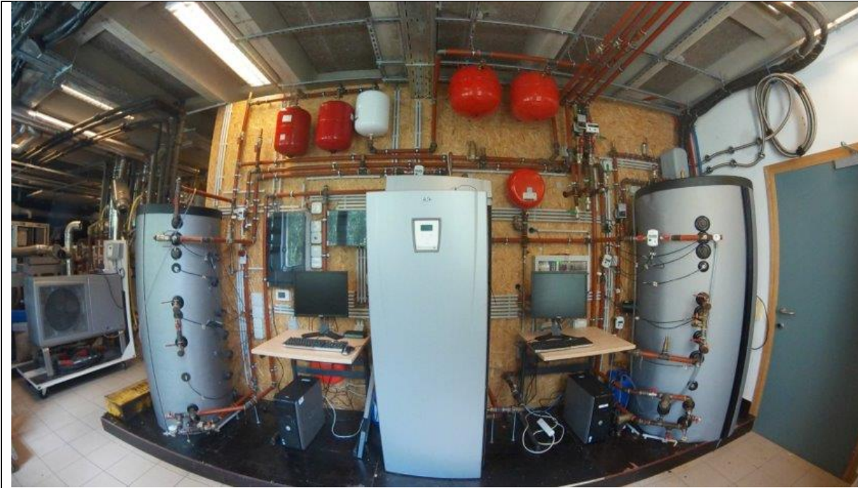
Opstelling voorzien van performante sturing en logging
